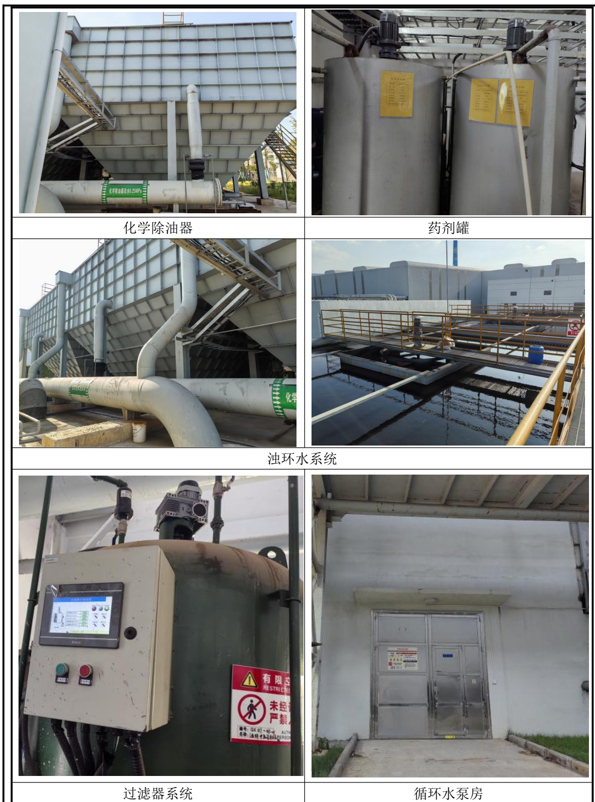
图 3-1 废水治理措施现状图
